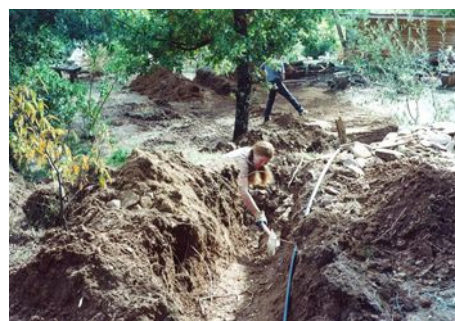
Protection des tuyaux
